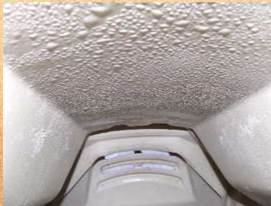
Kondenzace vzdušné vlhkosti na vnitřních površích VIB
